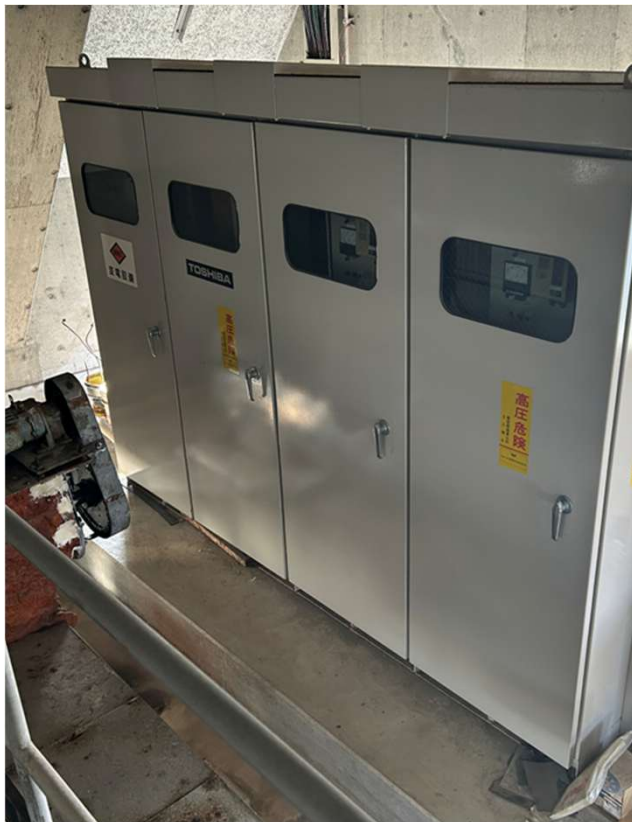
【設置されている変圧器】
