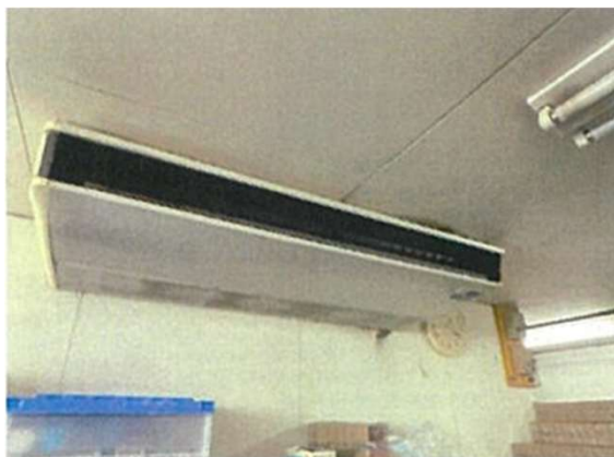
【現在設置されている空調設備の仕様】
