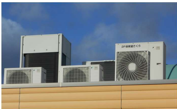
【現在設置されている空調設備】
