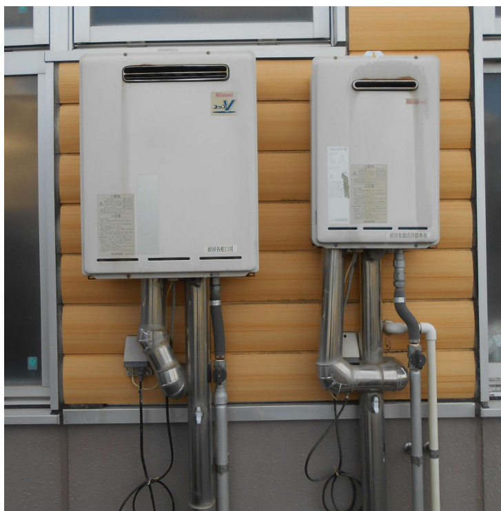
【現在設置されている給湯器】
