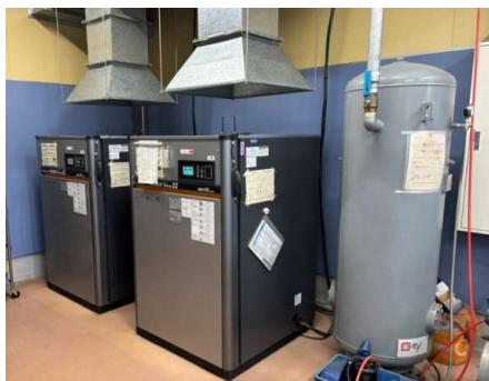
【設置されているコンプレッサ】
