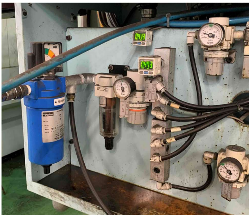
【工場内の空圧配管】
