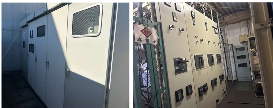
【設置されている変圧器】
