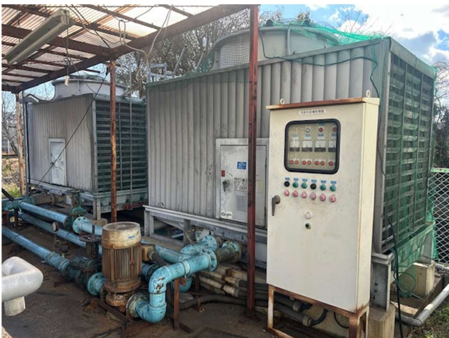
【冷却塔と制御盤】
