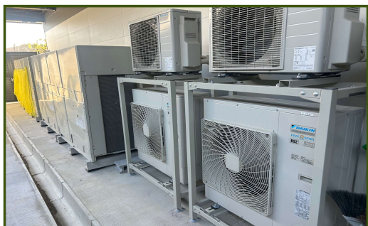
【高効率空調設備（室外機）】
