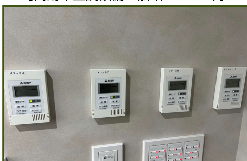
【高効率空調設備（操作スイッチ）】
